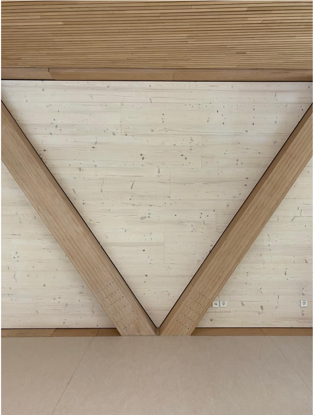
Abbildung 2: BauBuche Fachwerkträger im Nationalpark Zentrum Baiersbronn.
